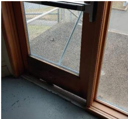
Rotting door bottom
