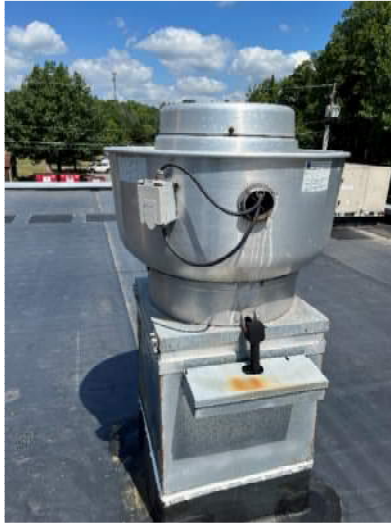
Existing Kitchen hood exhaust fan (EF-5)
